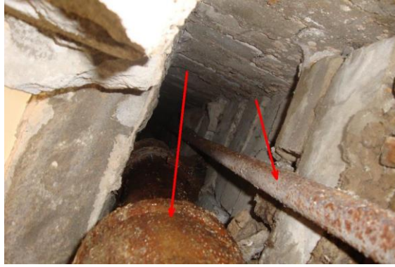
Väline korrosioon torustiku šahtis. Turu 11, Tartu, 1960-ndad.
