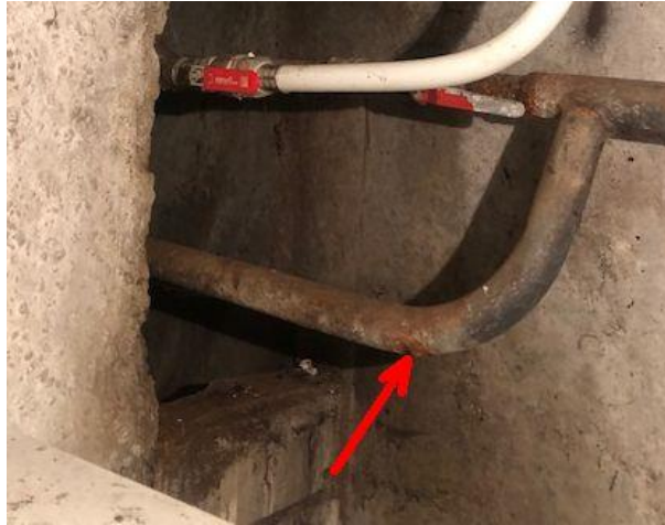
Punktkorrosiooni näide. Võnnu 11, Tartu, 1989.
