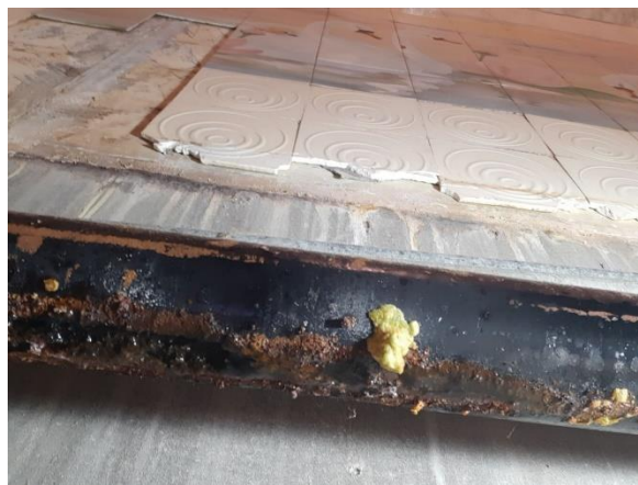
Torustiku väline korrosioon. Kaitsekiht on hajustunud. Torustik aastast 1987.
